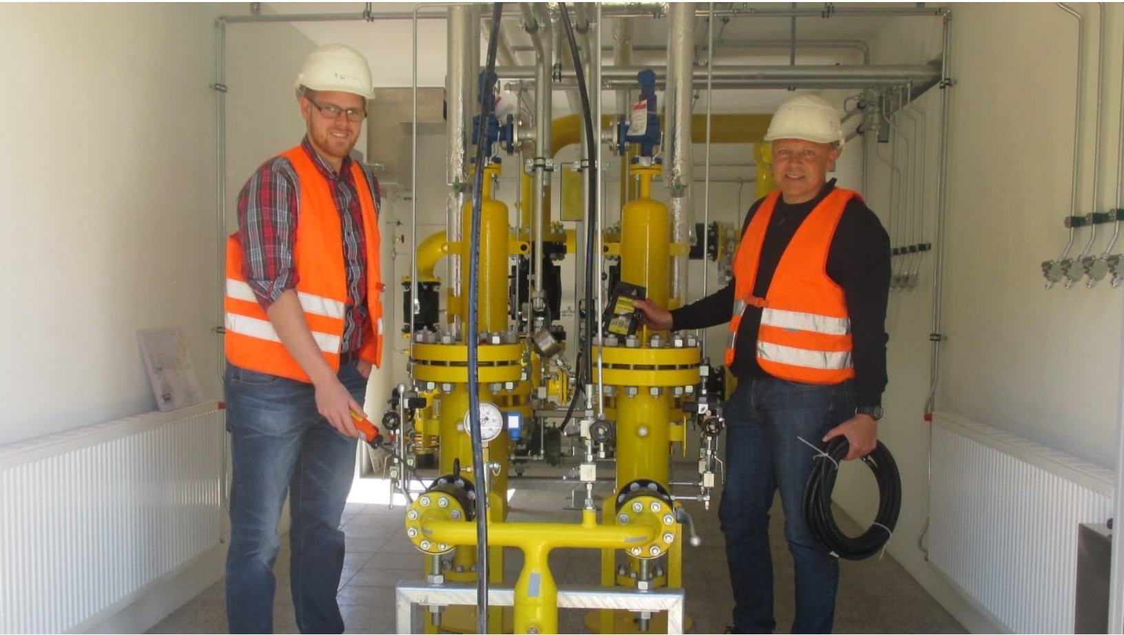
Matthias Gebel (l.) und Uwe Schiller, beide Westfalen Weser, prüfen noch einmal alle Komponenten der neuen Übernahmestation.
