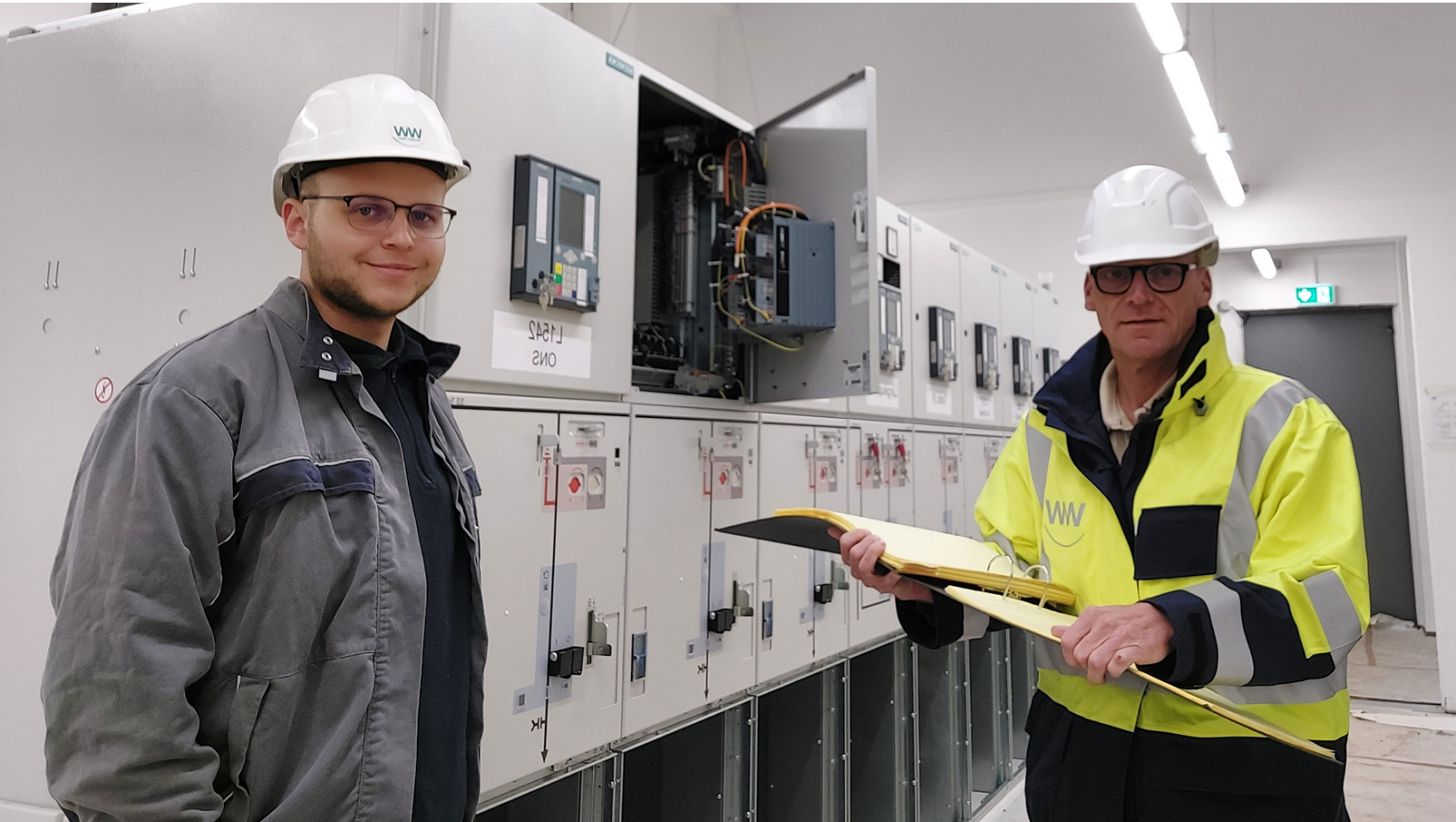
Projektleiter Frank Rathert (l.) und Schutztechniker Dominik Lasrich besprechen die anfallenden Arbeiten in der Schaltanlage.
